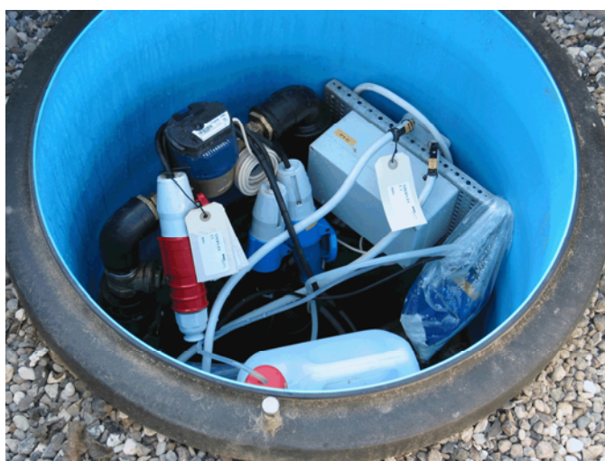
Figur 2.6 Perkolatopsamlingsbrønd med pumper, vandur, kontrolboks og perkolatopsamlingsflaske.
