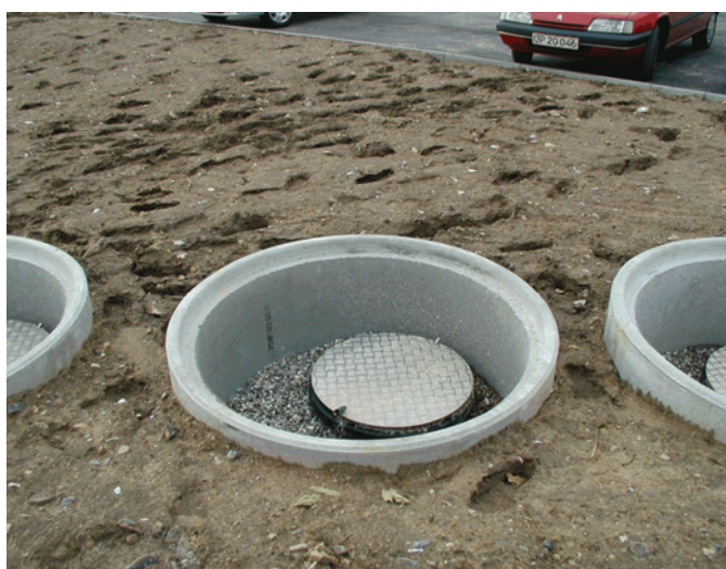
Figur 2.7 Perkolatopsamlingsbrønd med aluminiumsdæksel.
